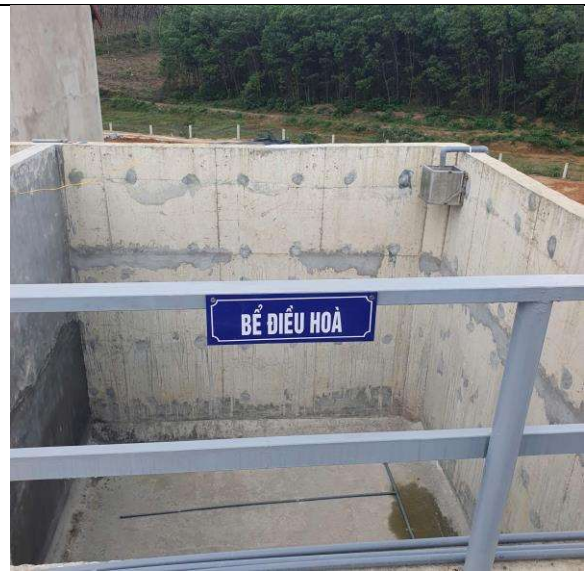
Bể điều hoà
