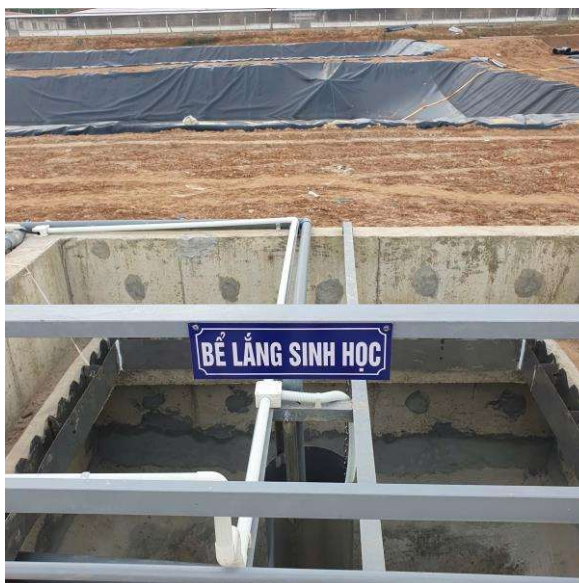
Bể lắng sinh học
