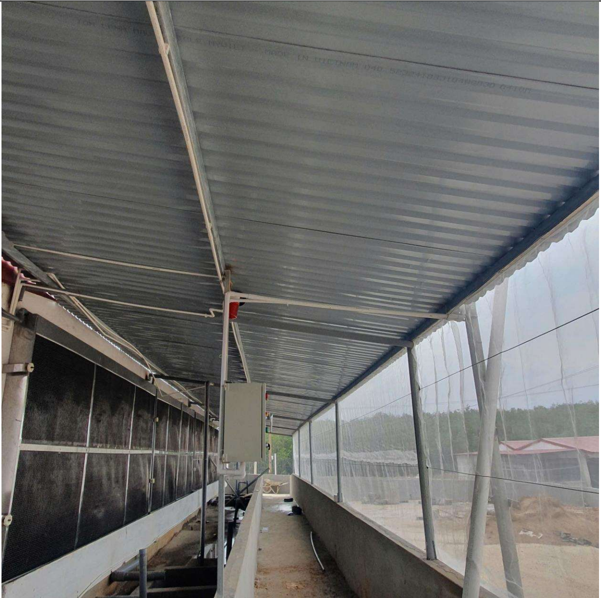
Hình 4. Hệ thống Cooling Pad và lưới chắn khử mùi sau quạt thông gió
