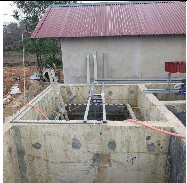
Bể lắng hoá lý 2
