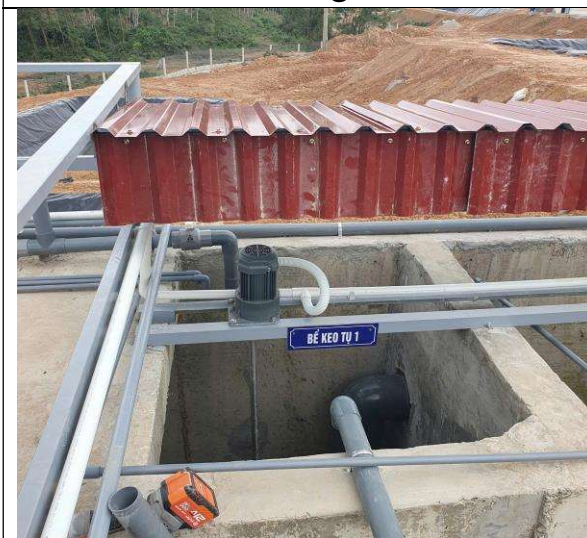
Bể keo tụ 1
