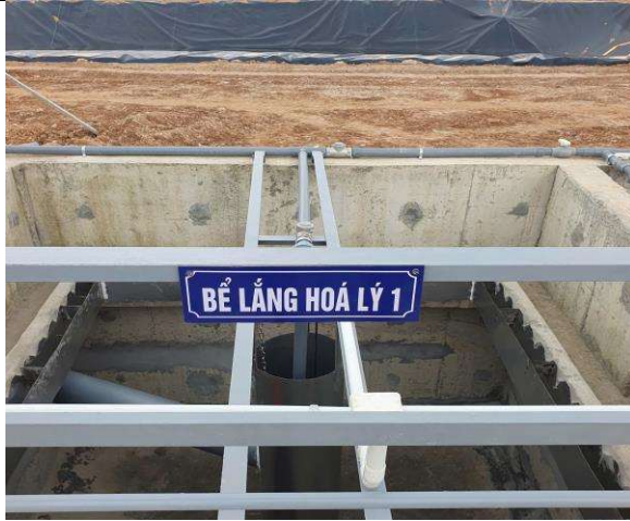
Bể lắng hoá lý 1
