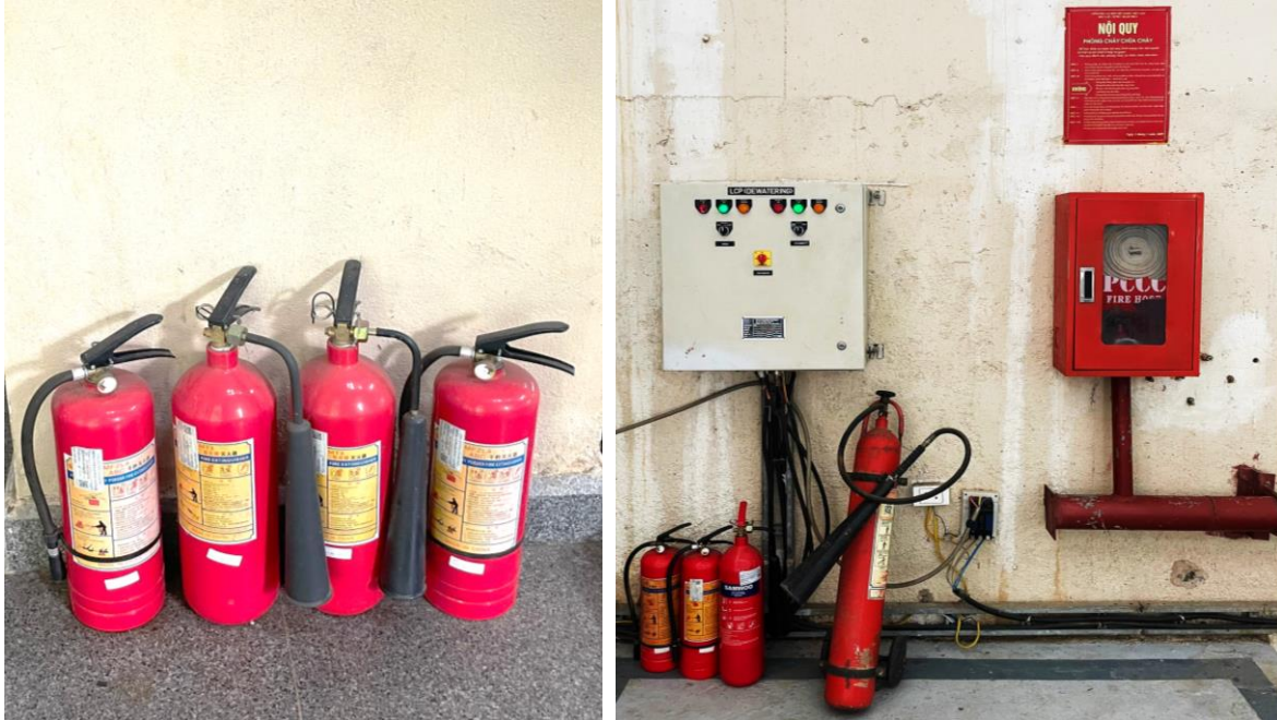
Hình ảnh 3.2. Thiết bị phòng cháy chữa cháy tại Cơ sở
