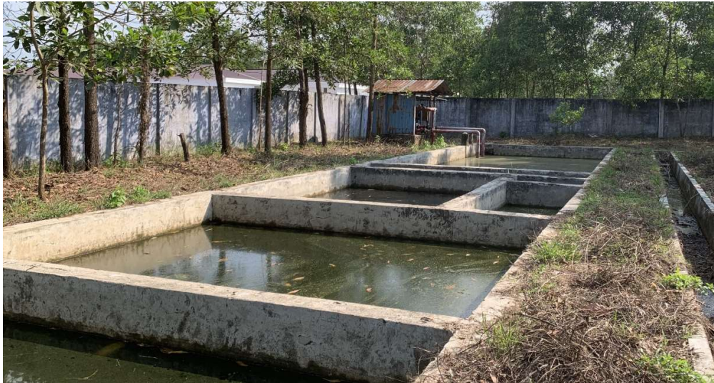
Hình 3.6. Hệ thống xử lý nước thải tập trung
